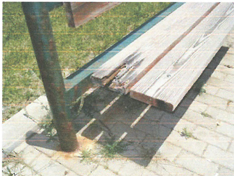
Εικ. 3. Αστοχίες ξύλινων κατασκευών υπαίθρου Τοπικής αυτοδιοίκησης
